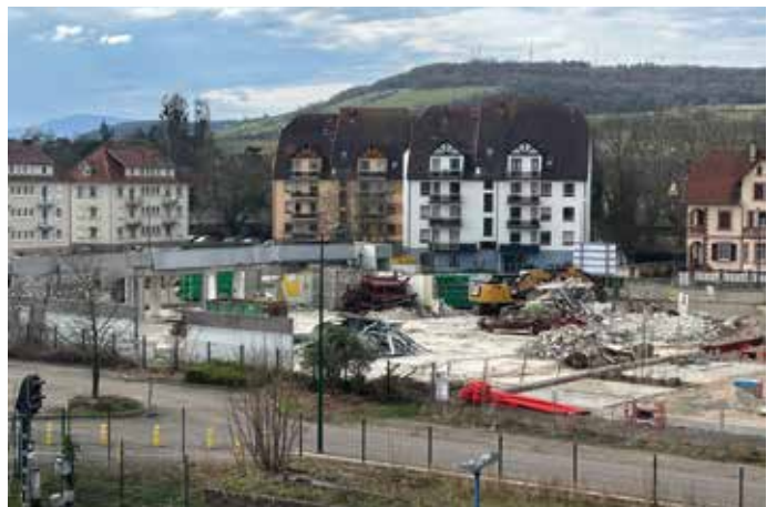
Le chantier de la démolition du bâtiment Jardina se déroule en parallèle avec l'aménagement des parkings de la Maison médicale Albert Schweitzer (document remis).
