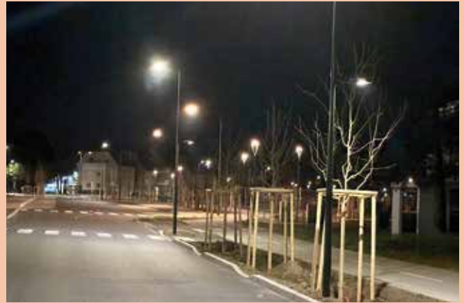
Des candélabres à technologie Led ont été implantés dans le quartier Henri-Meck
