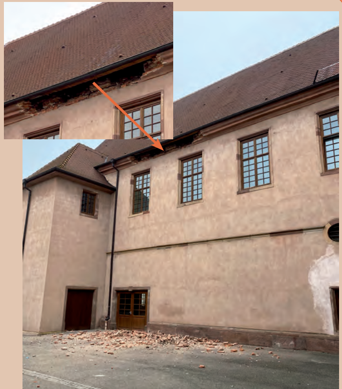
Des éléments de la corniche se sont effondrés sur le sol sans causer de dommages matériels ni humains.
