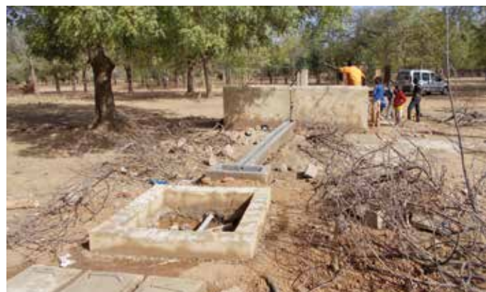
Parallèlement au forage, deux zones distinctes de puisage et d'abreuvement ont été installées pour éviter aux villageois de partager les ponts d'eau avec leur bétail.
