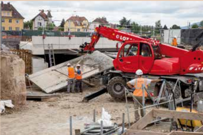
Les ouvriers procèdent au décoffrage du tablier piétons-cycles construit parallèlement à la voie ferrée.
