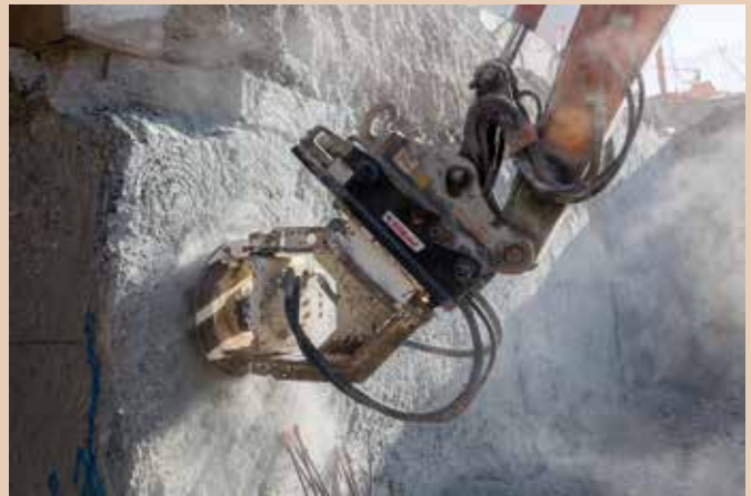
C'est au tour des parois moulées, côté Nord, d'être rabotées afin d'éliminer les plus grosses bosses.
