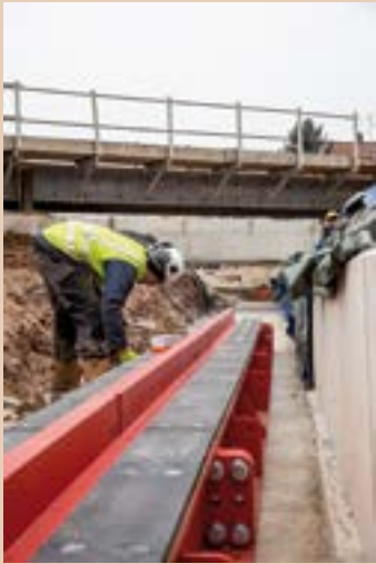
Pose des rails de guidage (en rouge) qui ont servi à l'opération de ripage des tabliers.
