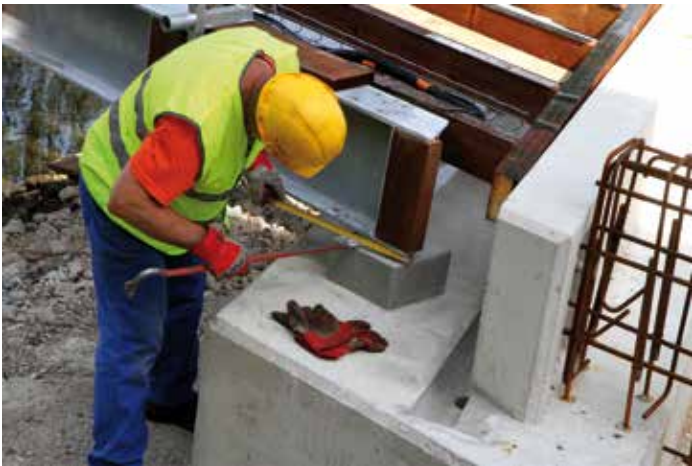
Les différents éléments ont été acheminés sur place et positionnés à l'aide d'une grue.
