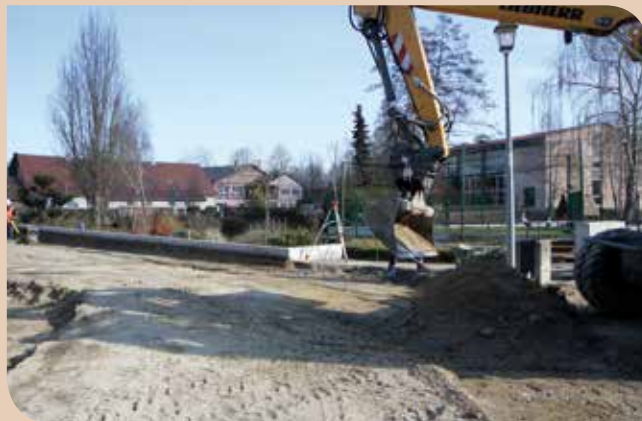
Le chantier a redémarré fin février avec le terrassement du carrefour et la pose des bordures.
