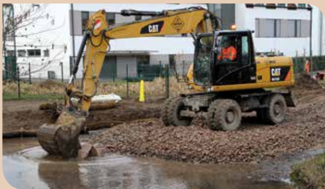
Afin de permettre l'installation du pilier central pour soutenir la future passerelle, les ouvriers effectuent un remblaiement provisoire du canal.
