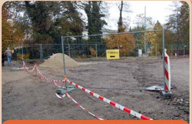
Un accès piétons sécurisé et élimité par des rubalises est maintenu pendant toute la durée du chantier.
