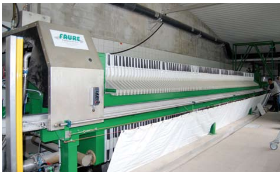
Avec ses 125 plateaux, le filtre presse permet de traiter 5 tonnes de boues en une pressée, soit une capacité de 900 tonnes de MS par an. Grâce à lui, la siccité a augmenté et les gâteaux de boue deviennent plus compacts (voir photo ci-dessus).
