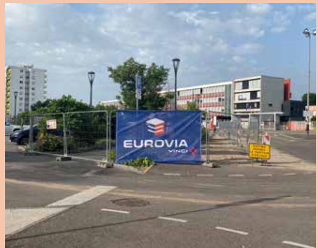
Les travaux ont démarré le lundi 19 juin. Les panneaux de déviation sont mis en place au fur et à mesure de l'avancement du chantier.
