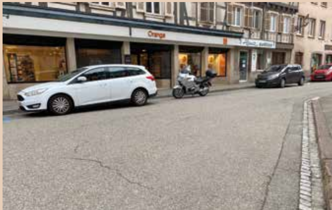
Les travaux de renouvellement de branchements d'eau démarrent par le bas de la rue de Saverne. La circulation sera interdite au droit du chantier en fonction de l'avancement des travaux.
