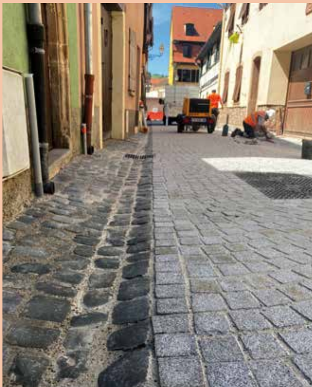
La rue Saint-Joseph est à nouveau ouverte à la circulation. Afin de préserver une partie des pavés historiques en porphyre bleu originaires de la carrière de Saint-Nabor, la Ville a décidé d'en utiliser pour habiller les caniveaux et les devants des façades de part et d'autre de la chaussée.
