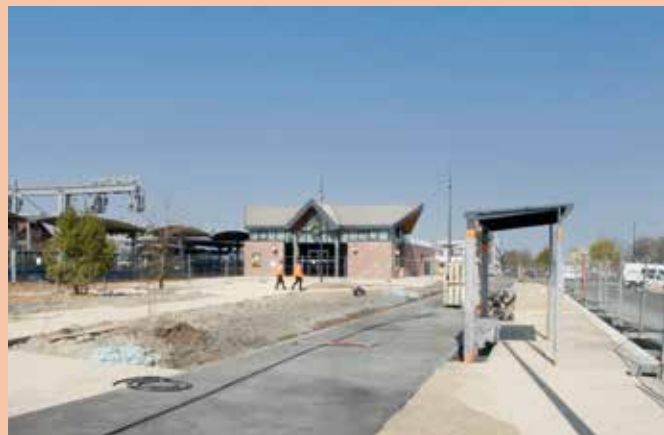
Les travaux d'enrobés et de pose de béton désactivé du parvis de la Gare sont terminés. Il reste encore à nettoyer et engazonner les différents espaces.
