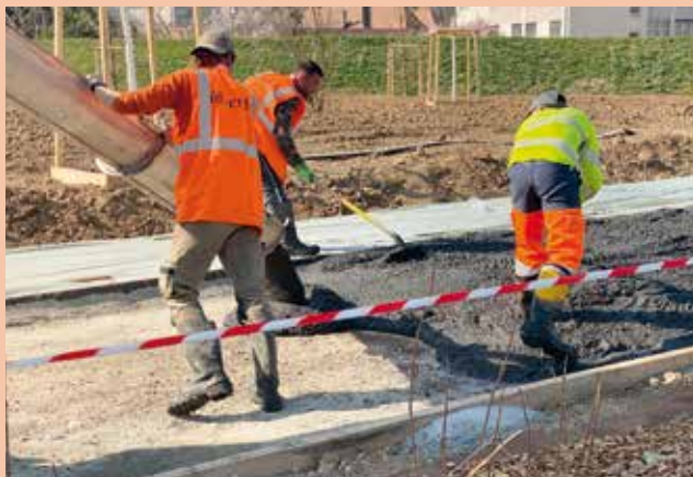
L'entreprise ID Verde a procédé aux derniers coulages de béton désactivé sur les pistes cyclables. Au total, ce sont 700 m 3 qui ont été utilisés sur l'ensemble du chantier.
