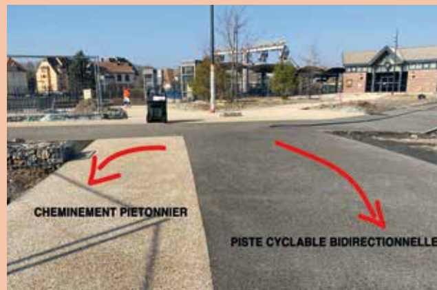
La Ville a choisi de recouvrir les différentes allées de béton désactivé sur l'ensemble du chantier avec un code couleur bien défini : beige clair pour les cheminements piétons et gris pour les pistes cyclables.
