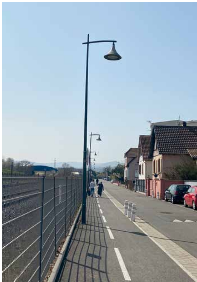
Le procédé Retrofit a permis de moderniser le système d'éclairage obsolète de la rue de la Fonderie en adaptant un kit sur les mâts existants.
